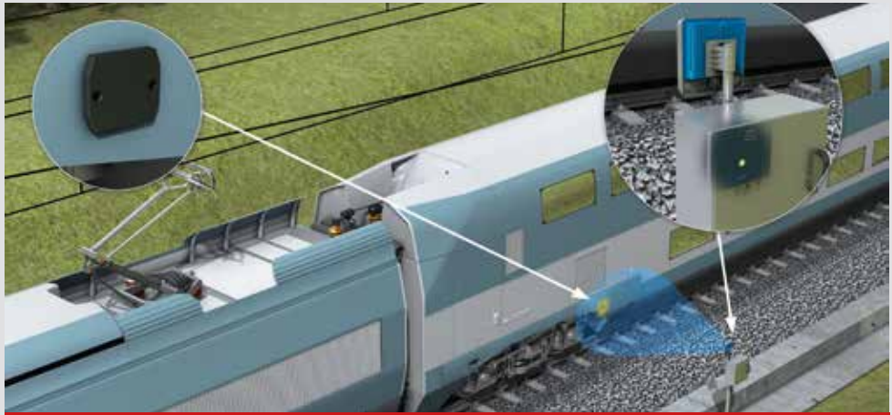
I dispositivi sono stati collocati in un cabinet, montato su un palo verticale
