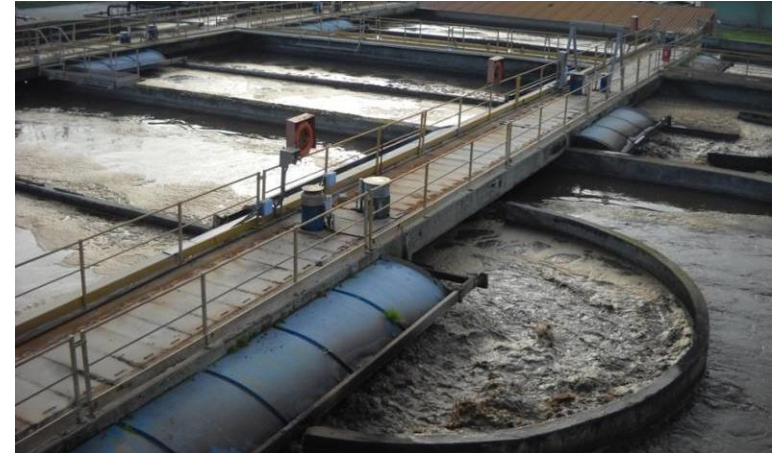
Depuratore di Viareggio (dal 1973)
