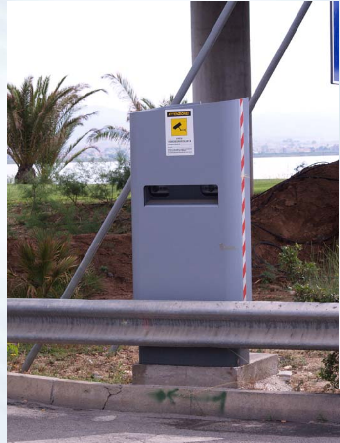
particolare dell'installazione dell'armadio AUTOVELOX
